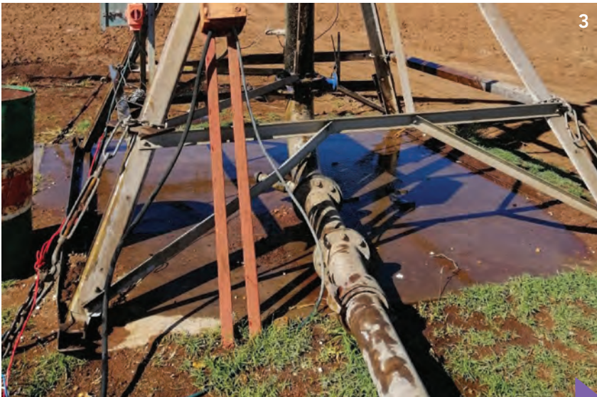
Lekkasje by die spil van stelsel L12 het tot laer toedieningsdoeltreffendheid bygedra.
