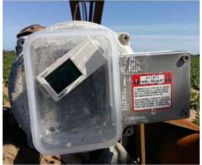
Figuur 8: Montering van elektromagnetiese sensor om spilpunt-looptyd te monitor
